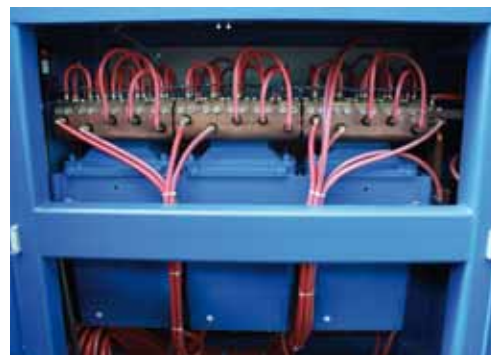
Anordnung von Trafo- und Gleichrichtersatz
