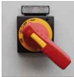
HAUPTSCHALTER gemäß VDE im Anbauschaltschrank installiert
