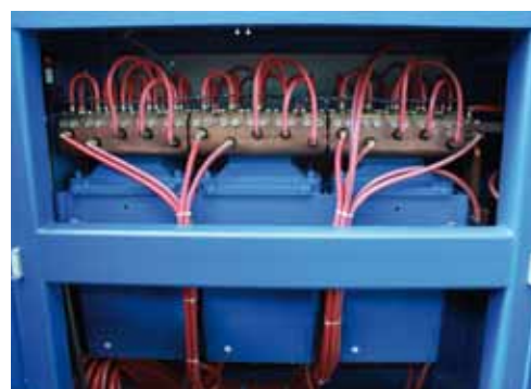
Anordnung von Trafo- und Gleichrichtersatz
